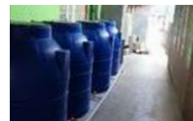
Sistema de reserva de agua
