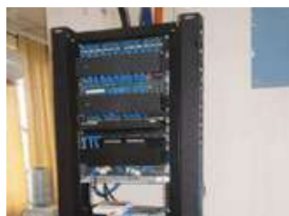
Estante metálico tecnológico (Rack)
