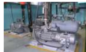
Bombas de succión
