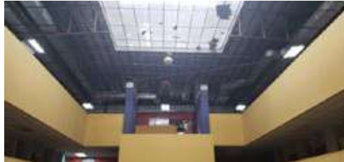
Reparación estructural de las escaleras y desmonte del cielo raso de metal
