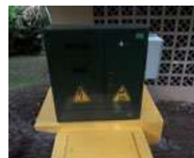
Instalación de transformador trifásico 300KVA en el edificio del Instituto de Geociencia
